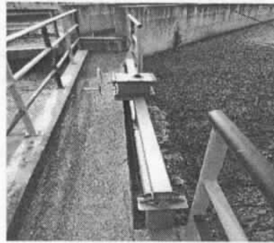
Figura 10. Compuerta de entrada tanque aerobio
