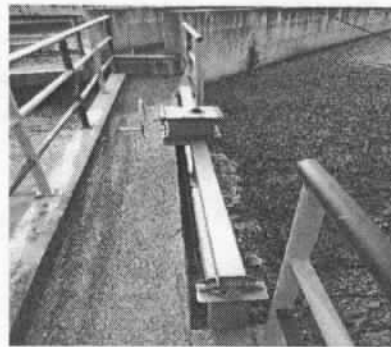
Figura 10. Compuerta de entrada tanque aerobio
