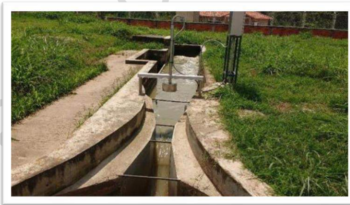
Fotografía 2. Sistema de medición de caudal y PH. Canaleta Parshall
