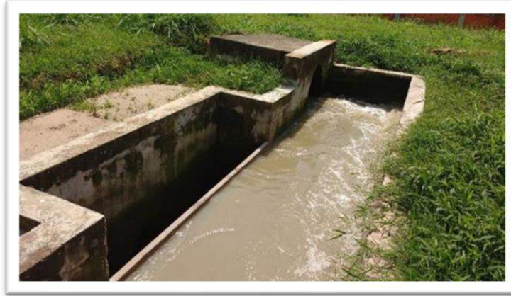
Fotografía 1. Llegada de aguas residuales y Estructura de excesos.
