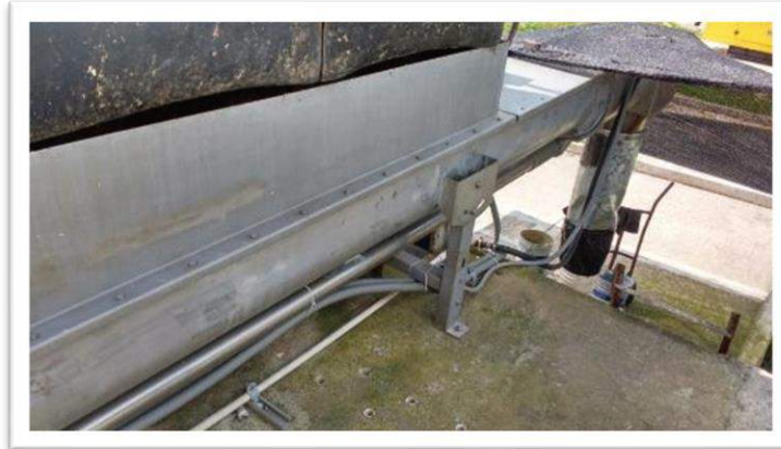
Fotografía 5. Transportador de residuos de Cribado.
