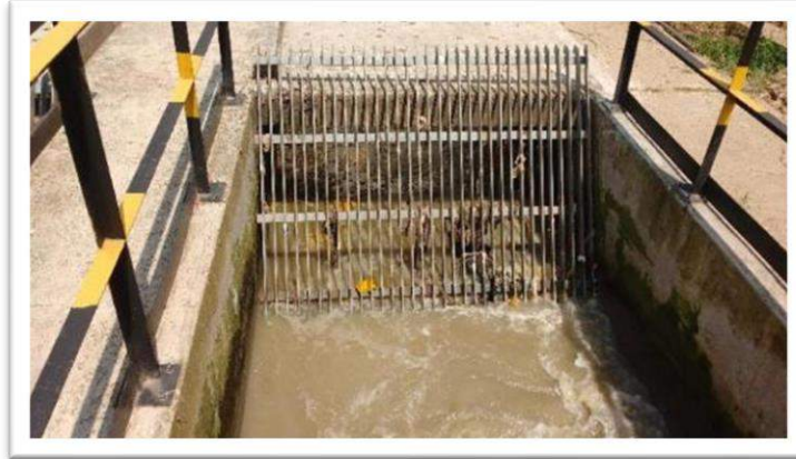
Fotografía 3. Rejilla de Cribado Grueso.
