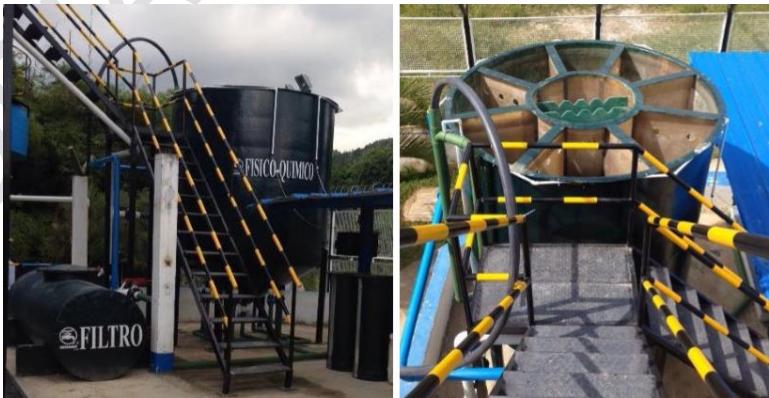
Fotografía 14. Tratamiento terciario. Fuente: Piedecuestana ESP
