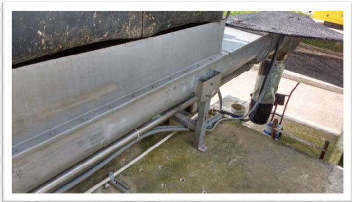
Fotografía 5. Transportador de residuos de Cribado.
