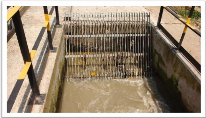
Fotografía 3. Rejilla de Cribado Grueso.
