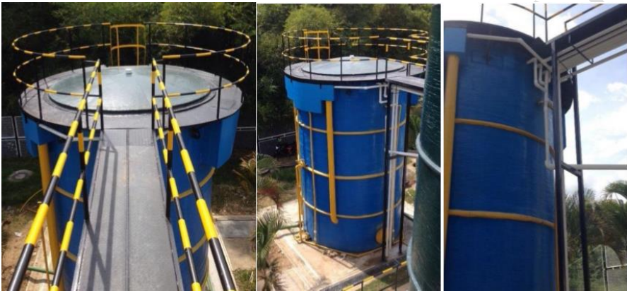
Fotografía 15. Deshidratacion de lodos. Fuente: Piedecuestana ESP.
